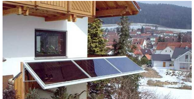
Solaranlage an Fassade
