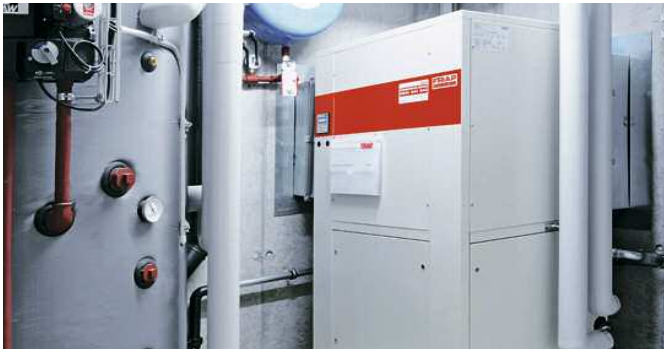
Baubewilligungsfreie Luft/Luft-Wärmepumpe mit Luftbezug im Haus
