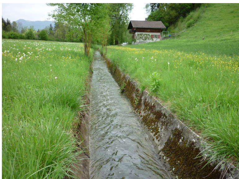
Foto 8 Chrebsbach in Halbschale
