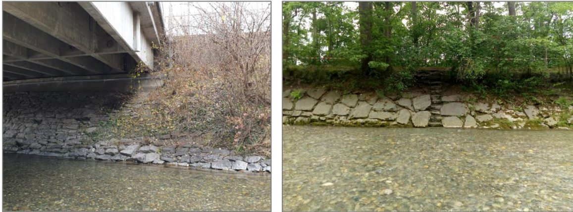
Abb. 10 LÄNGSVERBAU, LINKS: STARK ÜBERWACHSENE ALTE PFLÄSTERUNG (UNTER DER BRÜCKE SICHTBAR), RECHTS: SANIERTER BEREICH MIT GRÖßEREN WASSERBAUSTEINEN.
